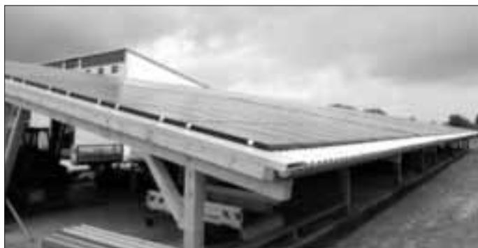
Die neuinstallierte PV-Anlage auf der Carport-Halle
