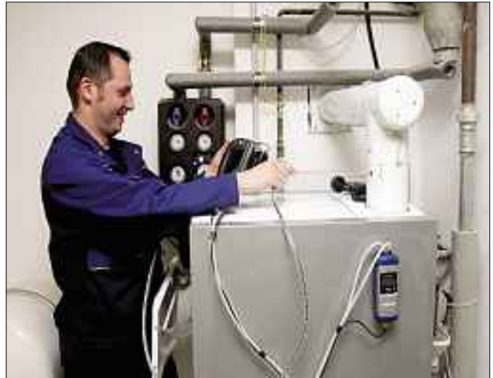
Viele Faktoren entscheiden darüber, ob die Heizung sparsam oder teuer ist: Beim Heizungs-Check prüft der Fachmann die gesamte Heizungsanlage auf Herz und Nieren. Foto: VdZ-interPress
